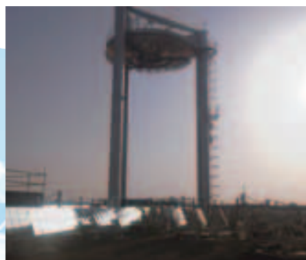
アブダビの太陽熱発電の実証施設
